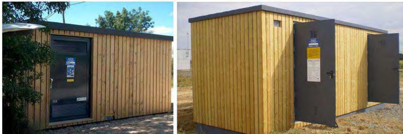
Photo 157 : Modèle choisi pour les postes de livraison : bardage bois et teinte grise (RAL 7016) pour les parties métalliques
