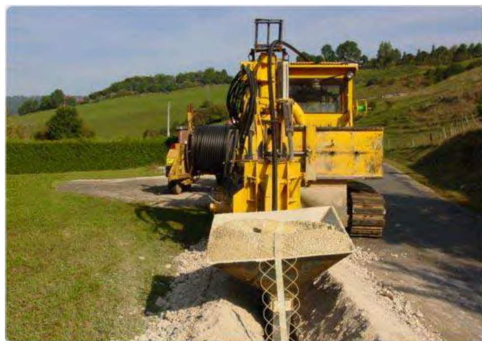
Photo 144 : la pose d'un câble souterrain depuis le poste de livraison jusqu'au réseau électrique public
