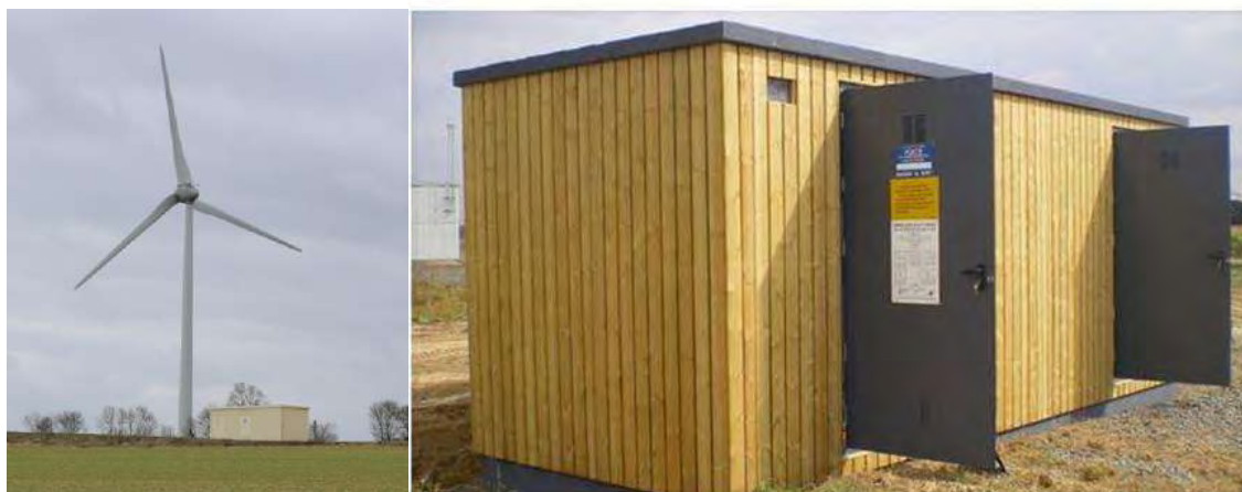
Photo 143 : exemples de poste de livraison électrique
